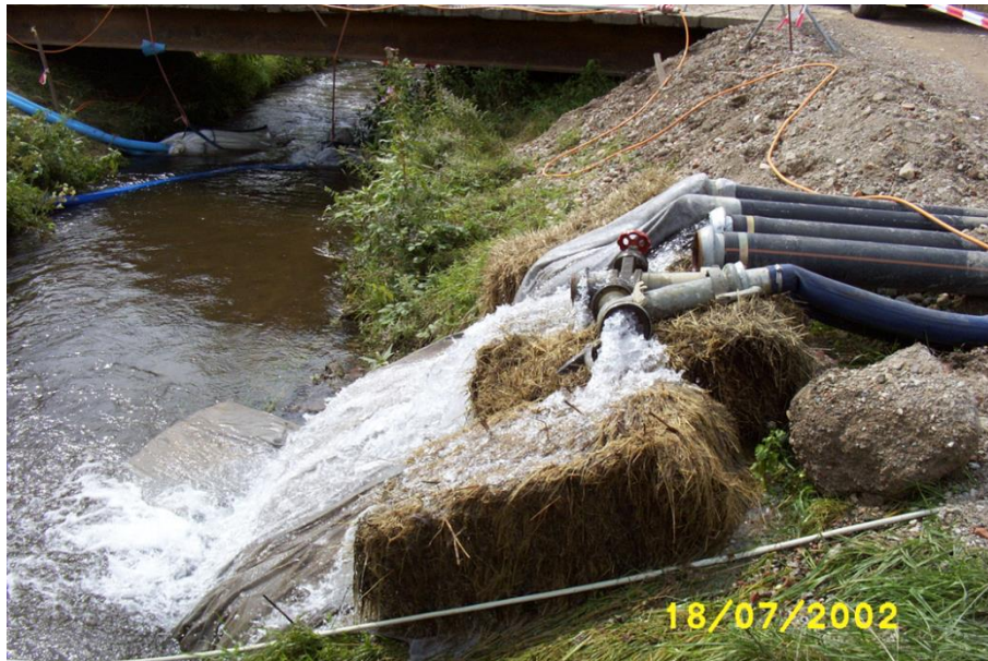
Abb. 24: Einleitung des geförderten Grundwassers in einen Vorfluter
