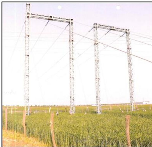
Abb. 31: Beispiel eines 110-kV-Freileitungsprovisoriums für zwei Systeme
