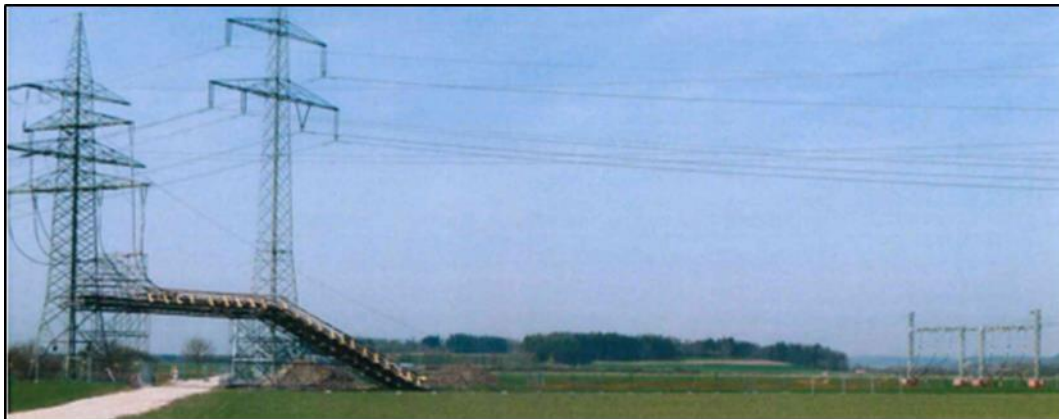
Abb. 32: Kabelbrücken im Bereich der Provisorien zur Querung von Straßen
