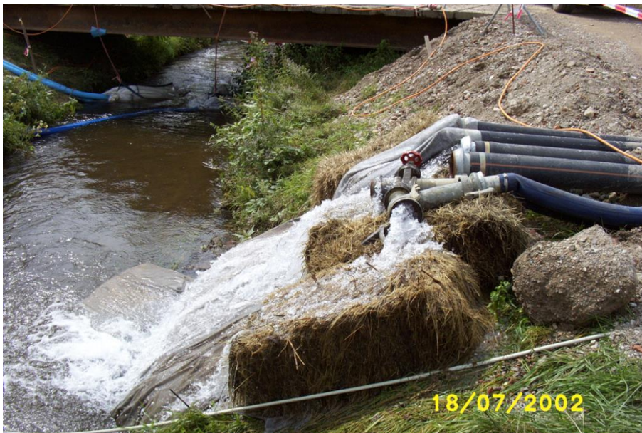
Abb. 17: Einleitung des geförderten Grundwassers in einen Vorfluter
